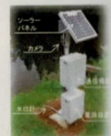
(県) ため池監視システム
